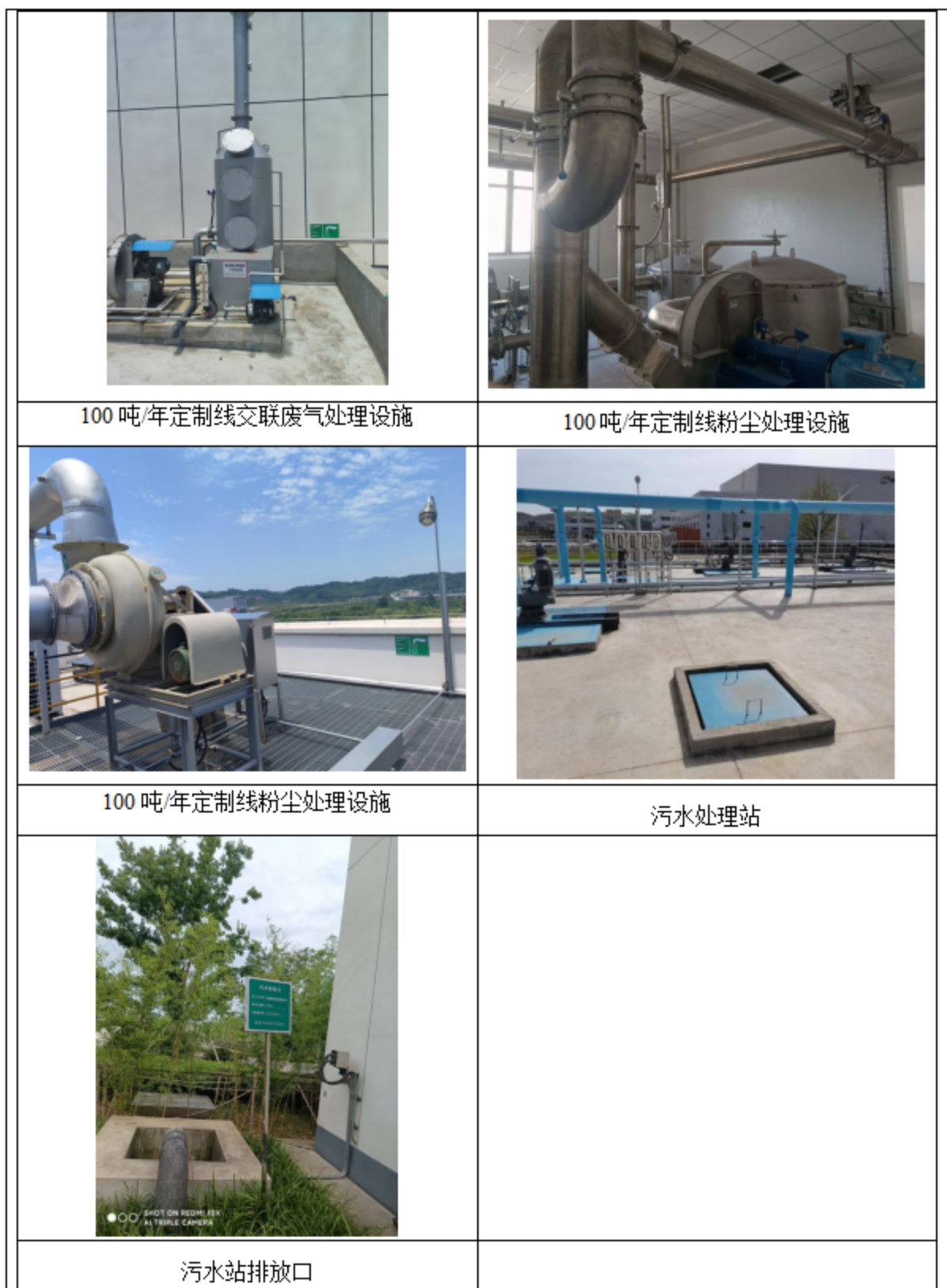
图 3-3 本项目废气、废水处理设施
