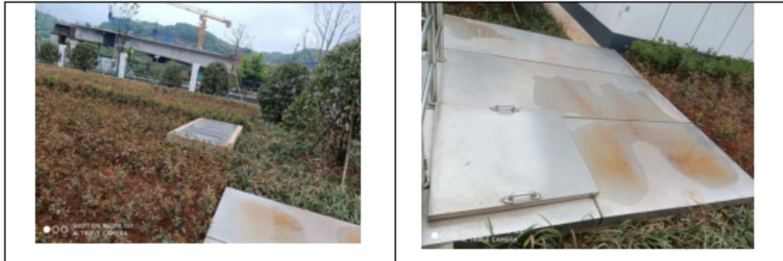
图 3-6 本项目事故应急池
